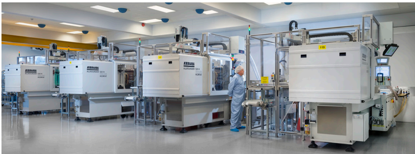
Det nya renrummet har ett effektivt system för försörjning av formsprutorna. Kopplingen till mediagången syns här längst ute till höger.
